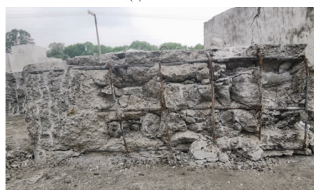
图9 不割断箍筋混凝土柱的内部破碎情况
